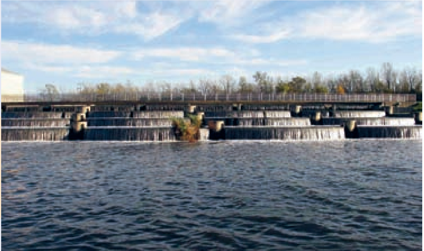
■ Tratamiento de aguas servidas. Descarga de aguas tratadas en el río Cal-Sag, Chicago, USA.
